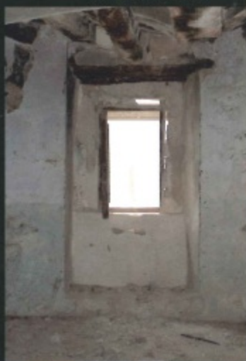
Vista interior del vano original de entrada a la torre, antes de las obras de 2006.
